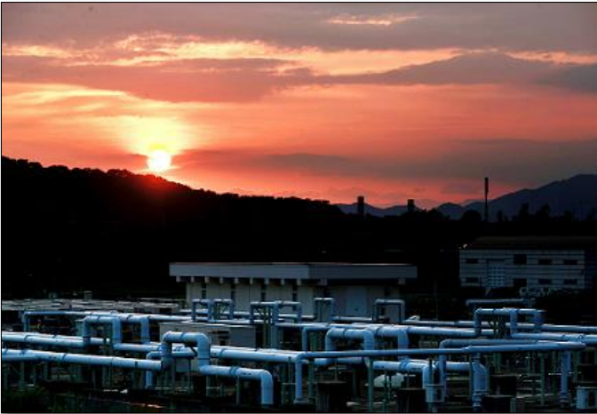
流域浄水事務所長賞『輝く浄化設備』 川合 定治
